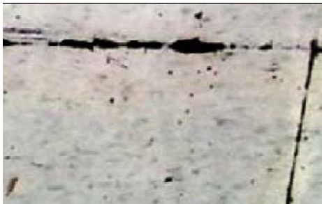
Sangrado del adhesivo en Losetas Vinílicas
