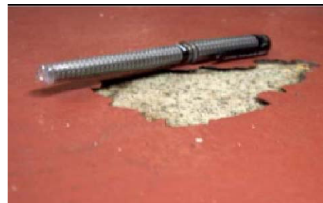
Desprendimiento de Morteros Epóxicos
