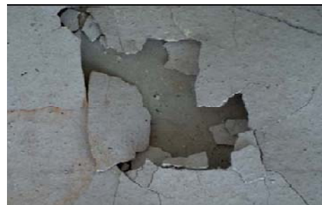
Desprendimiento de Sellos Epóxicos
